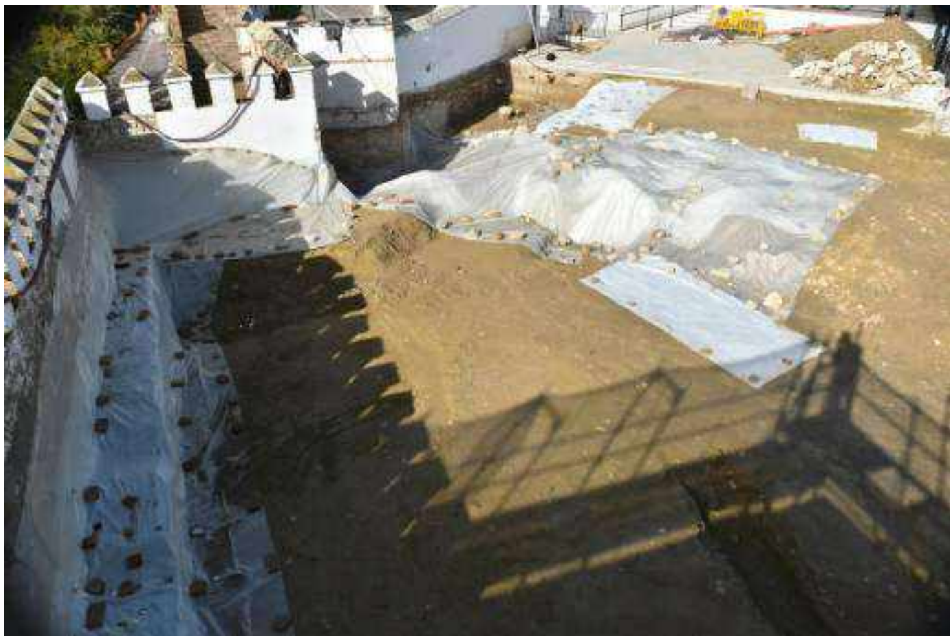
Lám. 197. Estado de la zona de intervención tras la conclusión de la primera fase de la excavación del Patio del Castillo de Santaella.
