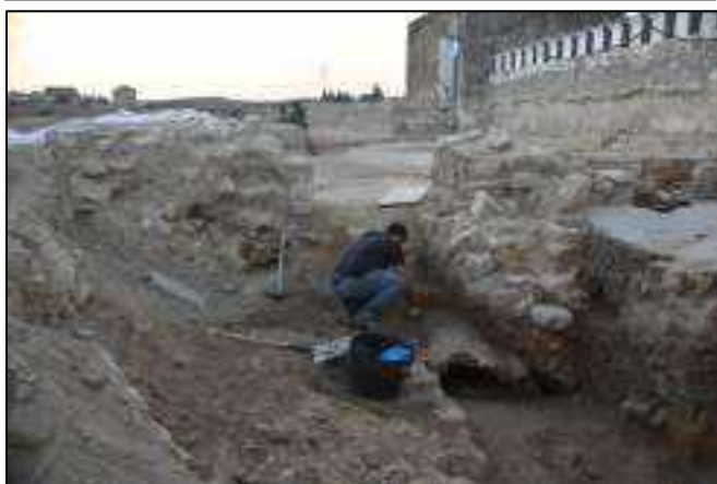
Lám. 149. Limpieza manual de la parte superior de la bóveda de ladrillo localizada en la parte W del recinto.
