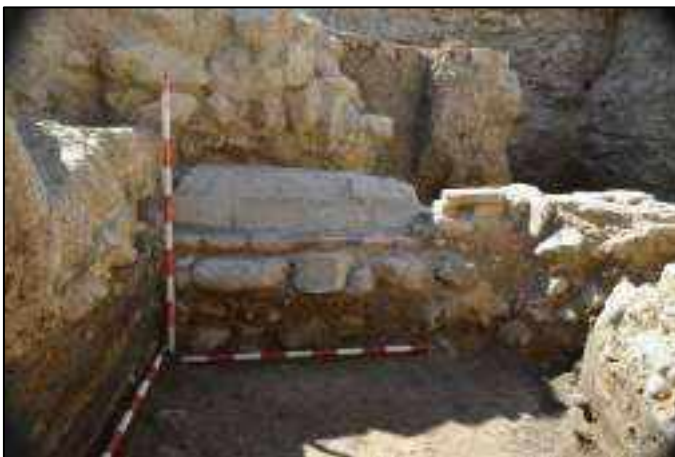
Lám. 186. Imagen de la cara exterior del muro N de la escalera tras realizar el sondeo.
