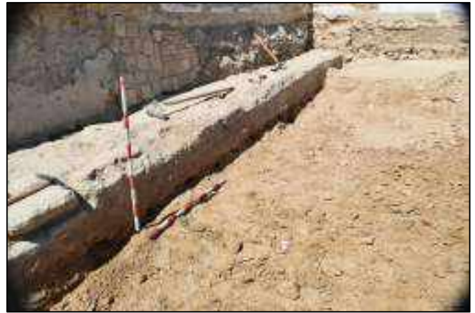
Lám. 67. Eliminación del pavimento del Espacio A de la casa del castillo.
