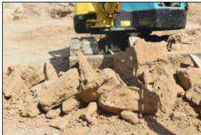
Lám. 84. Excavación mecánica del primer pavimento de la Casa del Castillo, compuesto de una capa de cal que se crea sobre una cama de mampuestos de pequeño y mediano tamaño.
