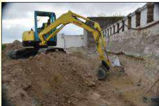
Lám. 9. Retirada del relleno de colmatación producto de la intervención realizada en 2017.
