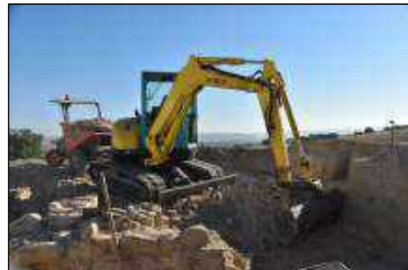
Lám. 51. Limpieza y acopio de materiales procedentes del derribo de los dos muros de ladrillo contruidos sobre la muralla E.
