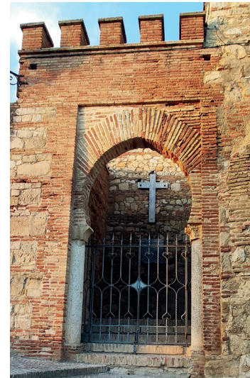
Figura 7. Estado en el que se encuentra actualmente la Puerta del Arco (Jesús Bascón Mateos)
