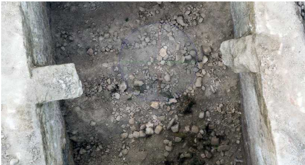
Lámina 12. Arco de descarga parcialmente derruido y que posiblemente soportara algún tipo de cubierta.
