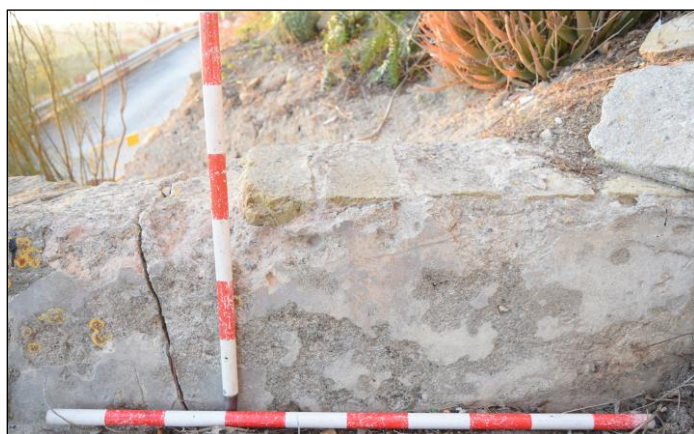
Lám. 30: Detalle del muro longitudinal W de la estructura hidráulica (U.E 16). Se observa el revestimiento que posee al interior y la hilada de ladrillo que conserva en su parte superior (posible inicio de la bóveda de cañón que cubriría)
